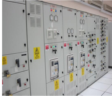
Hệ thống tủ điện
