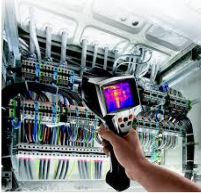
Đang dùng camera ảnh nhiệt đi quét tìm vị trí sự cố phát nóng tủ điện
