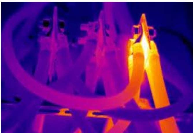
Hình ảnh 1 pha bị lệch tải nên nóng hơn 2 pha còn lại tại vị trí cáp điện nối thanh cái
