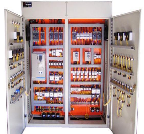
Tủ điều khiển
