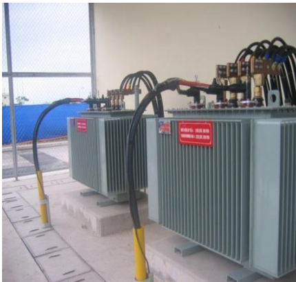
Trạm biến áp
